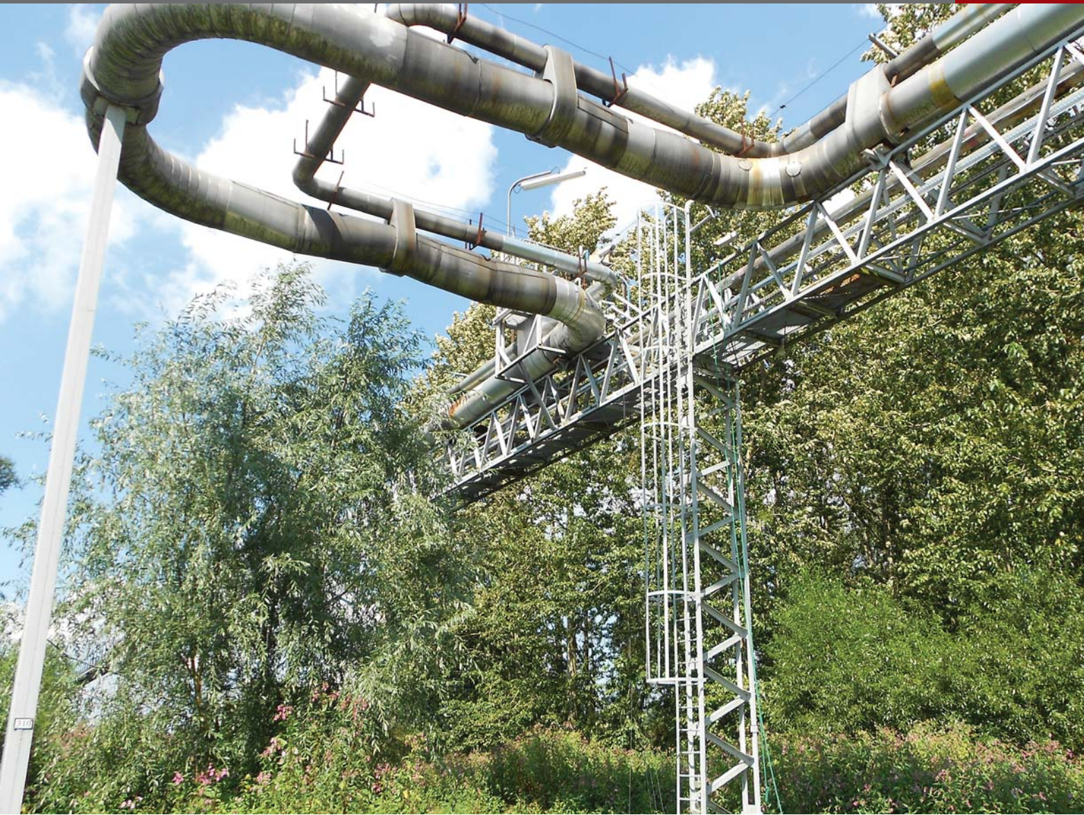
Rurociągi przemysłowe amoniaku – w terenie poza zakładem – kompensator
