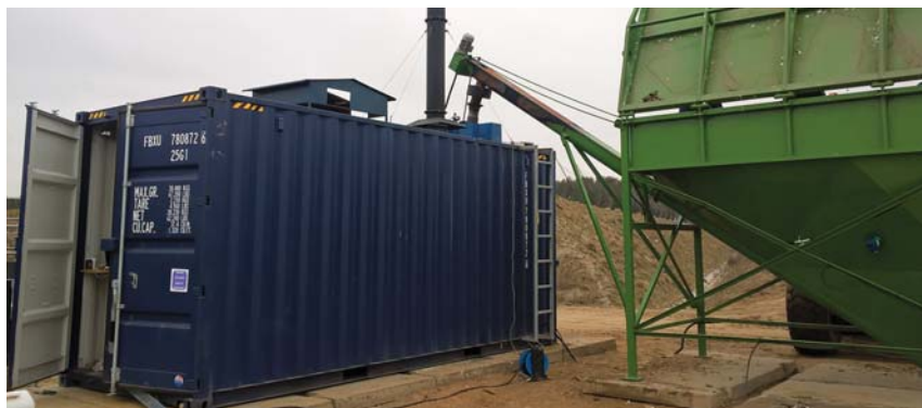
Instalacja zgazowania odpadów na terenie Zakładu Zagospodarowania Odpadów w Nowym Dworze
